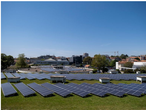
Painéis Fotovoltaicos, Águas e Energia do Porto
