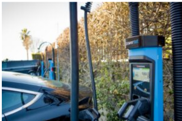
Ponto de carregamento Powerdot
